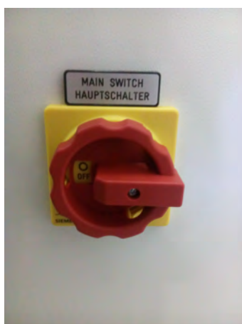
Imagen 13. PARO DE EMERGENCIA
