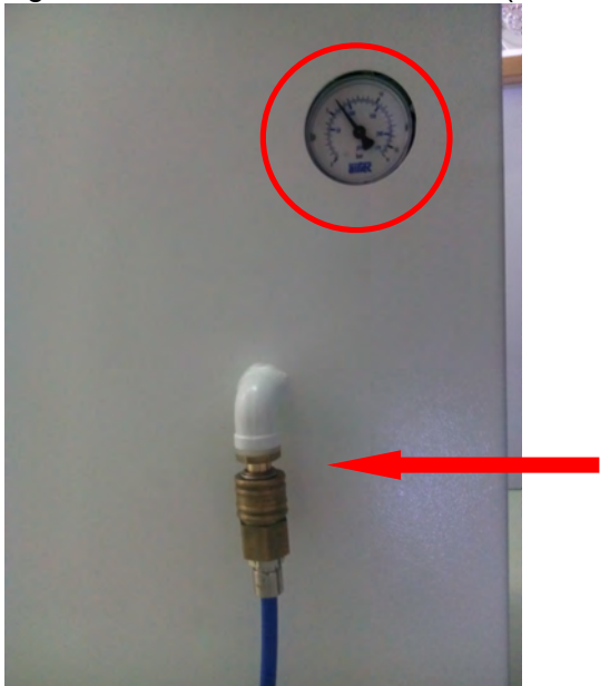
Imagen 8. Conexión de aire comprimido
